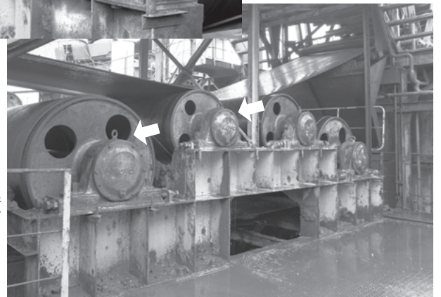
■原料搬送装置
